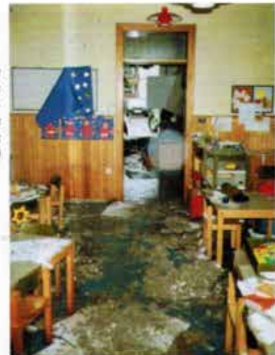
Wasserschäden im Erdgeschoss und der neue Zugang zum 1. Obergeschoss (links)
